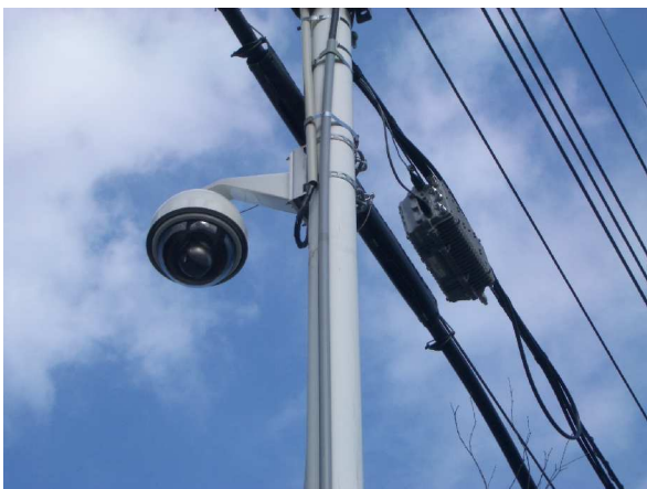
防犯カメラの設置例映像
